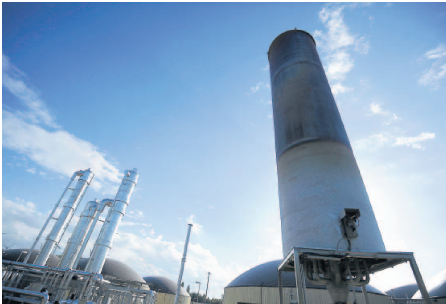
Die neue Biogasanlage neben der Kunnersdorfer Deponie ist weder von der Ferne noch der Nähe zu sehen. Erst auf dem Betriebsgelände an der S 127 zeigt sich die hochmoderne Anlage, hier links mit dem Herzstück, dem Biogasverstärker und rechts der Notfackel. Fotos: Pawel Sosnowski
