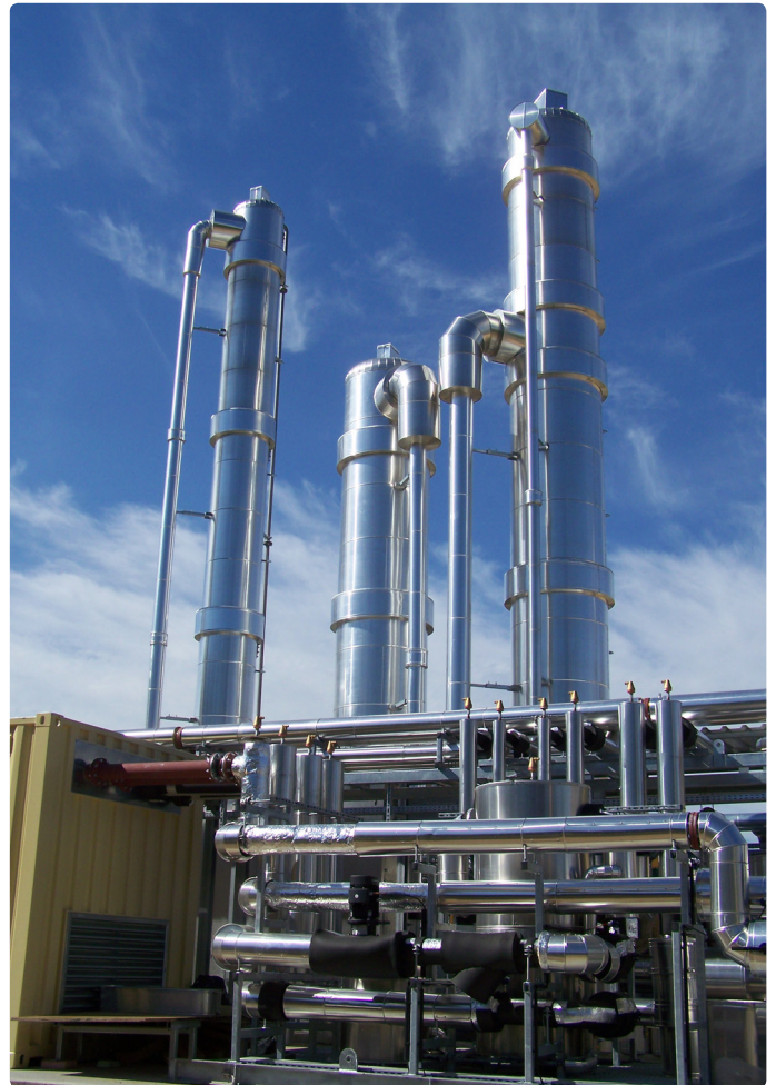
Gasaufbereitungsanlage in der Biogasanlage Schöpstal
